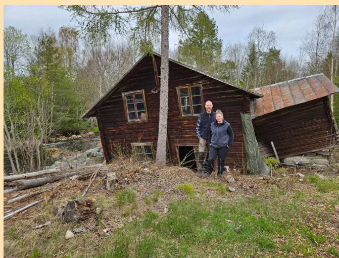
Att "kvara" står på trekvart blir tydligt i denna bild. Byggnaden ska rätas upp, ett projekt Andreas och Therese håller på att planera för. (Bild: Birgit Lundgren)
